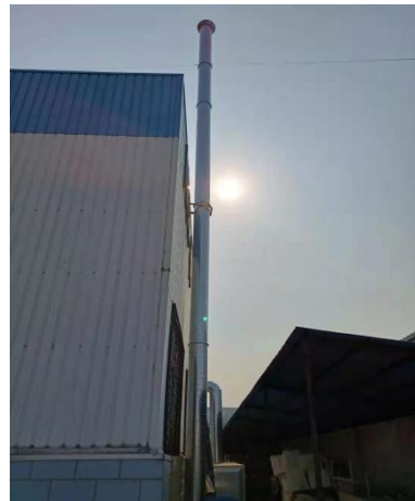
除尘器排气筒
