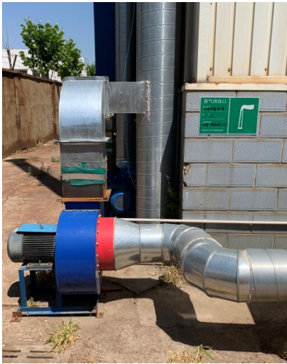
排气口标志牌
